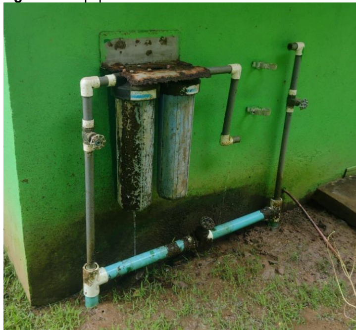
Figura 12 Equipo de “filtros” en la estación San Pedrillo.
