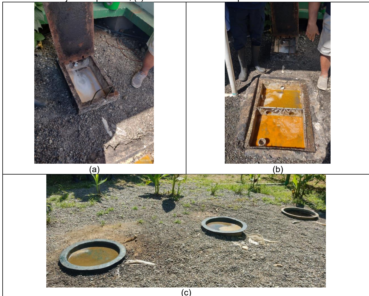
Figura 5 Componentes del sistema de trampa de grasas y aceites: (a) caja de recepción; (b) caja de separación; (c) reservorios antes de disposición en el suelo.
