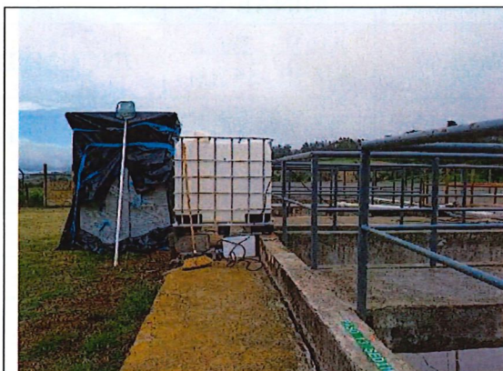
Figura 1. Tanqueta con sustancia química que se adicionó en sedimentador secundario durante la etapa de muestreo. Fuente: elaboración propia, inspección de campo PTAR SIGMA, agosto de 2026.
