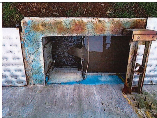
Figura 2. Unidad de aforo y toma de muestras posterior a la última etapa de tratamiento de la PTAR. Fuente: elaboración propia, inspección de campo PTAR SIGMA, agosto de 2026.
